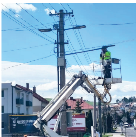
Údržba osvetlenia priechodov pre chodcov
