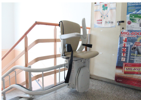
V rámci bezbariérového prístupu na zdravotné stredisko sa vybudovala výťahová sedačka pre pacientov
